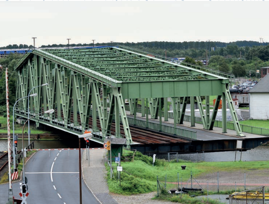
Seit Jahren ist die Drehbrücke im Kaiserhafen kaputt und muss dringend erneuert werden.
